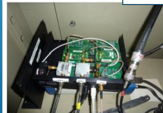
L'électronique utilisée pour monter une antenne VHF
